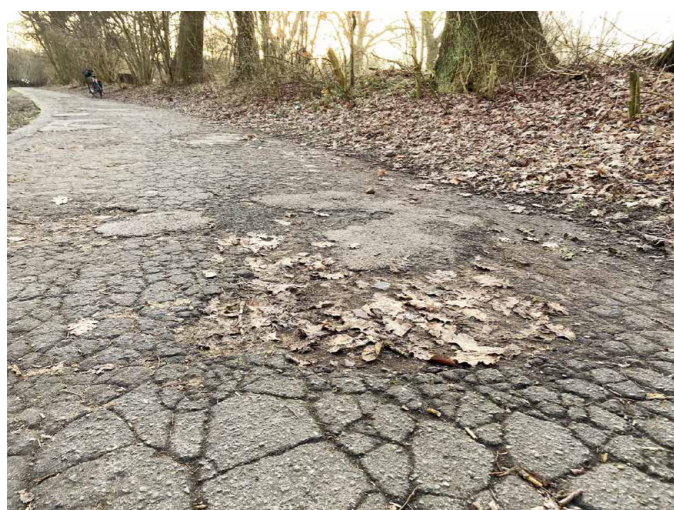
So beschädigt war der Weg noch vor der Ausbesserung
