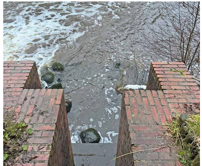
Alte Fischtreppe. Der gemauerte Durchlauf der alten Fischtreppe hat nie wirklich funktioniert.
